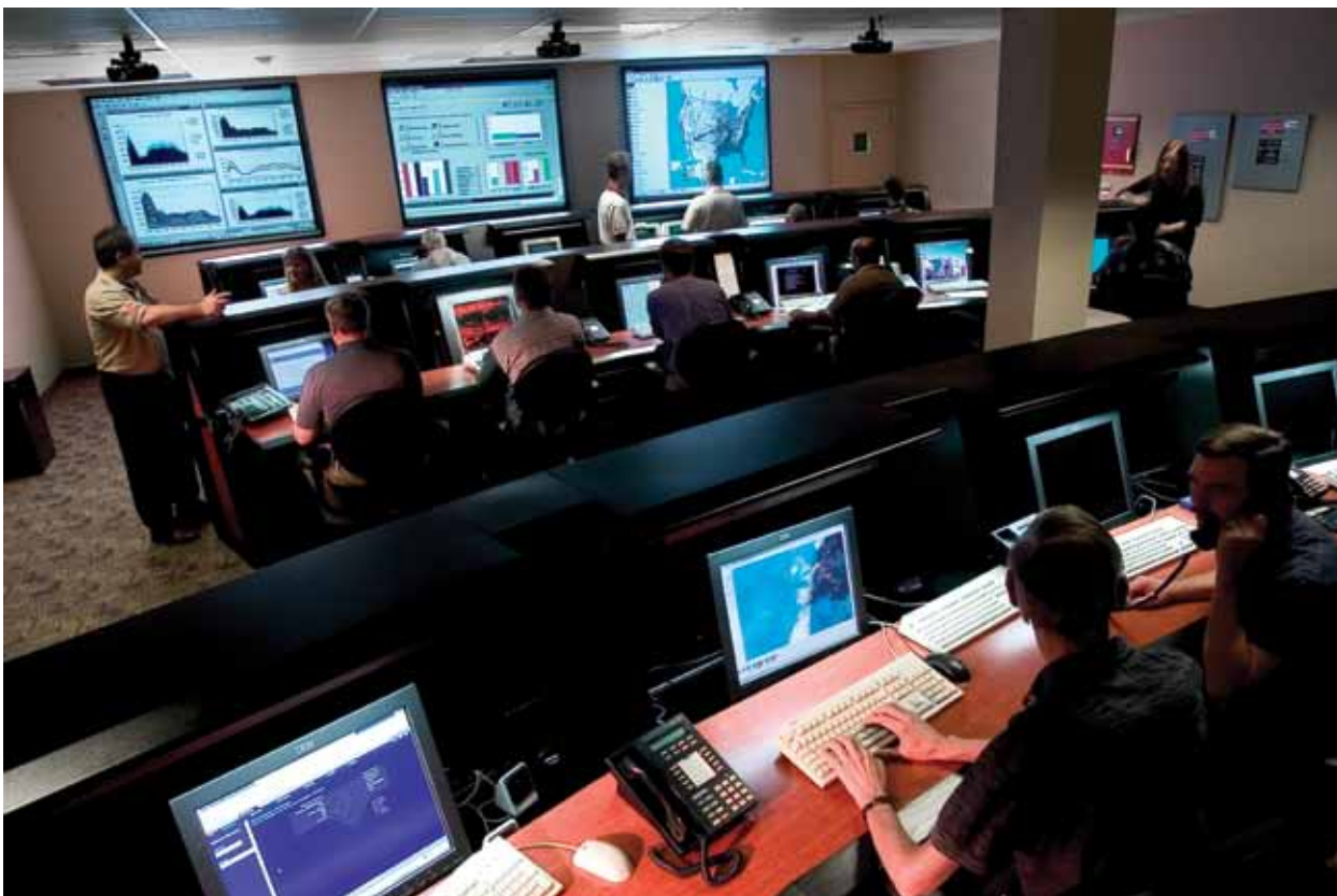
La sala mundial de control de TI en Chandler, Arizona es el corazón de nuestras comunicaciones, almacenamiento de datos y actividades empresariales con clientes y proveedores.
